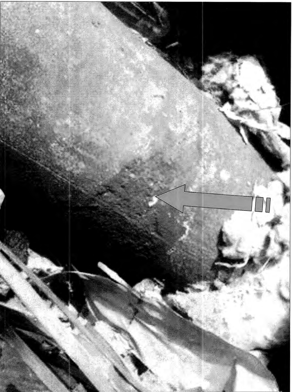
Фактическое состояние грубопровода по выявлению диагностики Фото. 9.3
